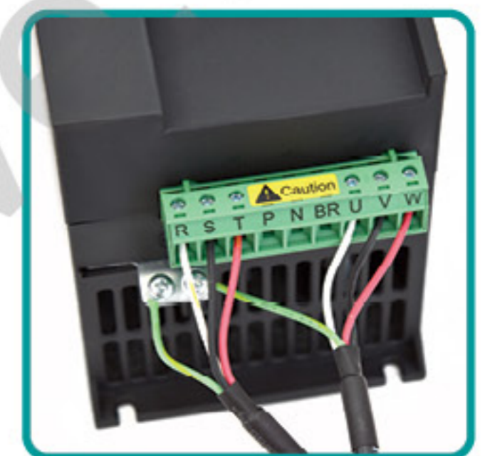
Подвод кабелей снизу
